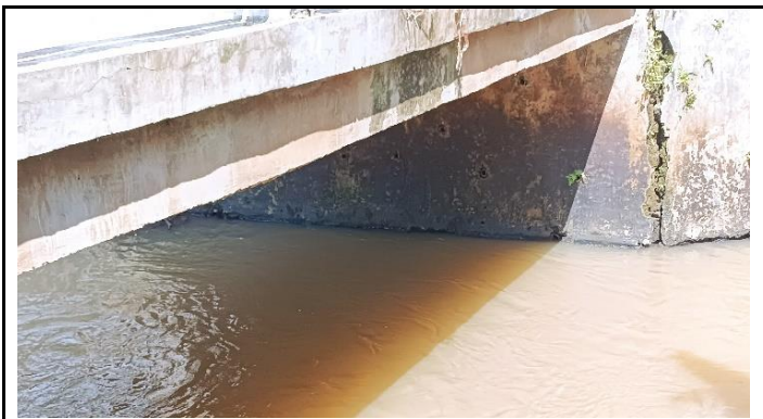
KONDISI KEPALA JEMBATAN RETAK
