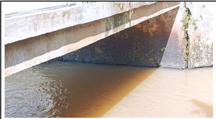
KONDISI KEPALA JEMBATAN RETAK
