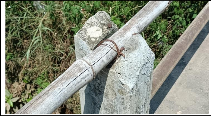
KERUSAKAN PADA SANDARAN
