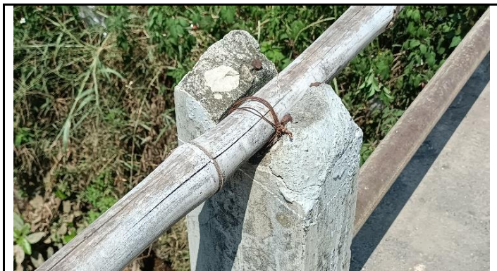
KERUSAKAN PADA SANDARAN
