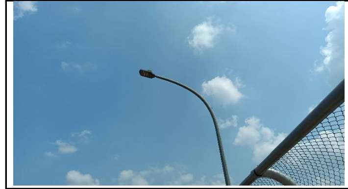
KONDISI LAMPU PENERANGAN JEMBATAN
