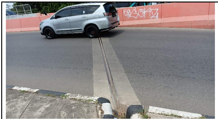
KONDISI SAMBUNGAN SIAR MUAI
