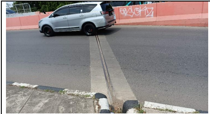
KONDISI SAMBUNGAN SIAR MUAI
