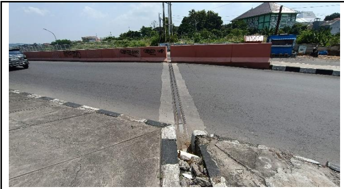
KONDISI SAMBUNGAN SIAR MUAI
