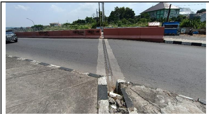
KONDISI SAMBUNGAN SIAR MUAI
