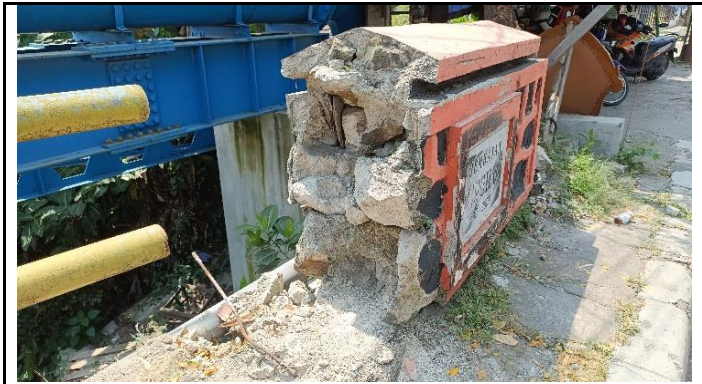
KERUSAKAN PADA TEMBOK SEDADA
