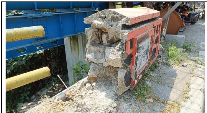
KERUSAKAN PADA TEMBOK SEDADA
