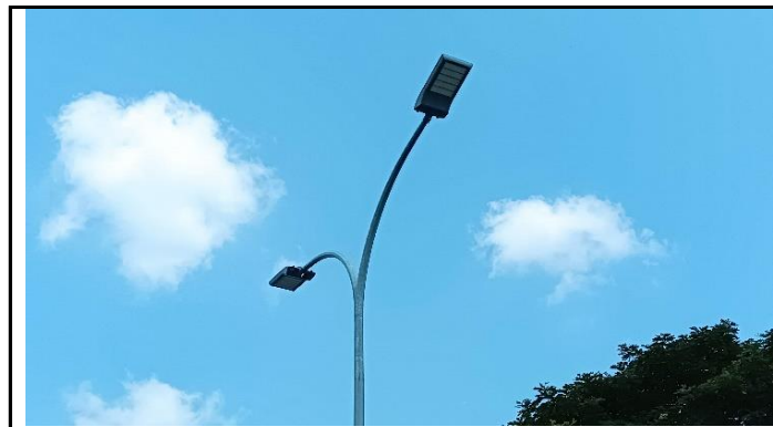
KONDISI LAMPU PENERANGAN
