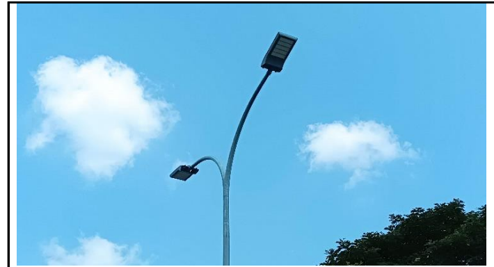
KONDISI LAMPU PENERANGAN
