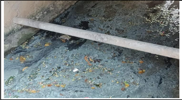
KONDISI PIPA UTILITAS PIPA AIR MINUM
