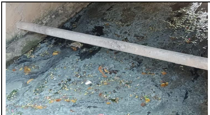
KONDISI PIPA UTILITAS PIPA AIR MINUM
