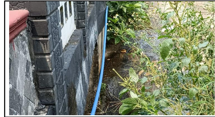
PIPA UTILITAS KABEL PROVIDER
