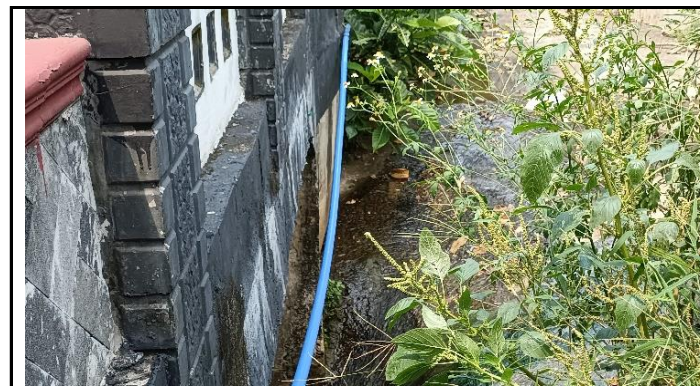
PIPA UTILITAS KABEL PROVIDER
