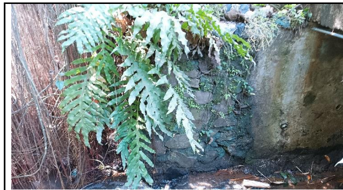
KONDISI TEBING SUNGAI
