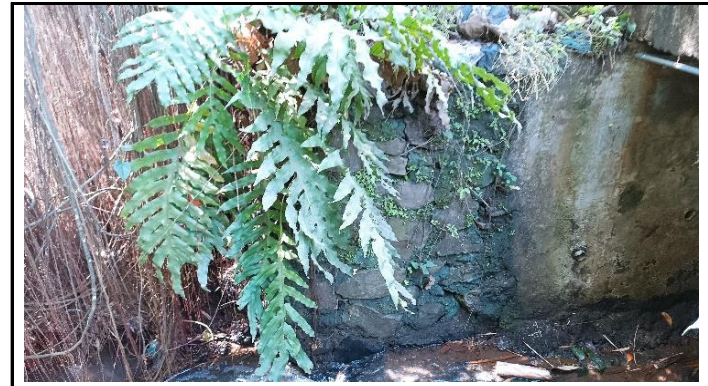
KONDISI TEBING SUNGAI
