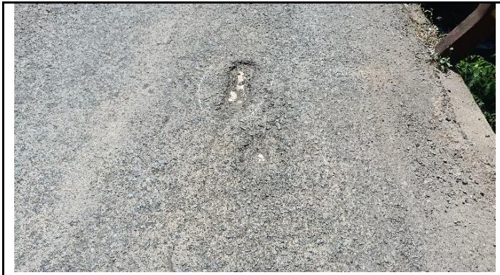
LAPISAN PERMUKAAN LANTAI BERLUBANG
