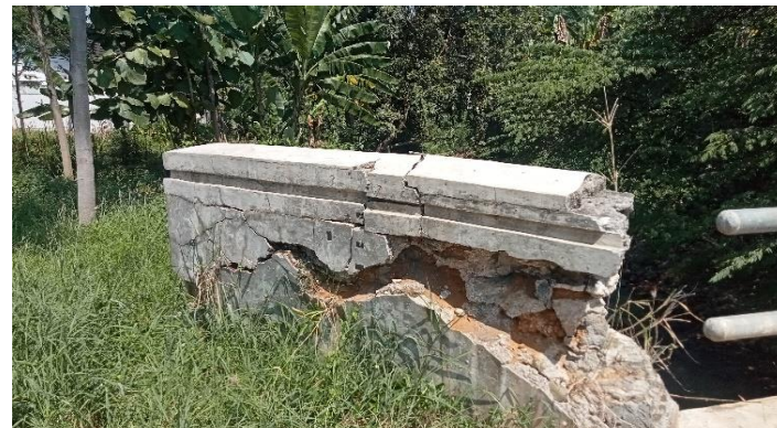
PARAPET / TEMBOK SEDADA PECAH
