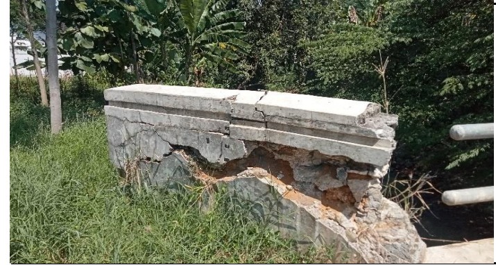
PARAPET / TEMBOK SEDADA PECAH
