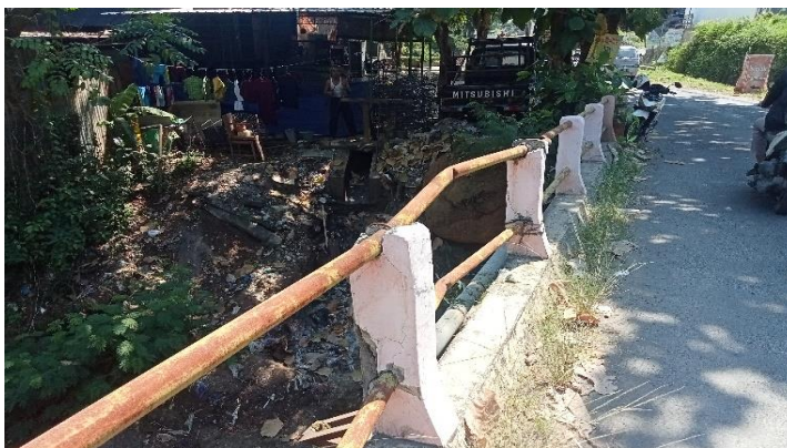
TIANG SANDARAN PECAH DAN SANDARAN HORIZONTAL MENGALAMI PERUBAHAN BENTUK
