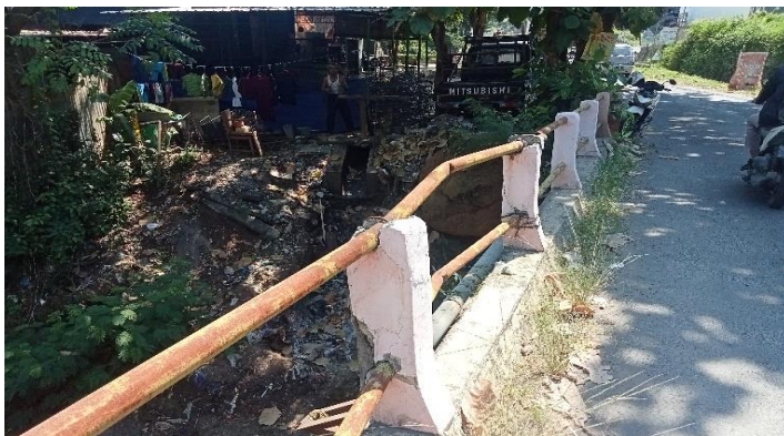
TIANG SANDARAN PECAH DAN SANDARAN HORIZONTAL MENGALAMI PERUBAHAN BENTUK
