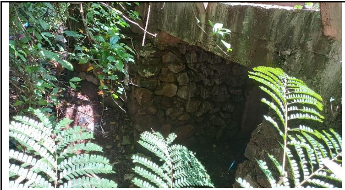
KONDISI PELAT JEMBATAN
