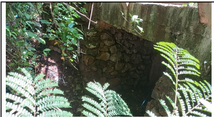
KONDISI PELAT JEMBATAN
