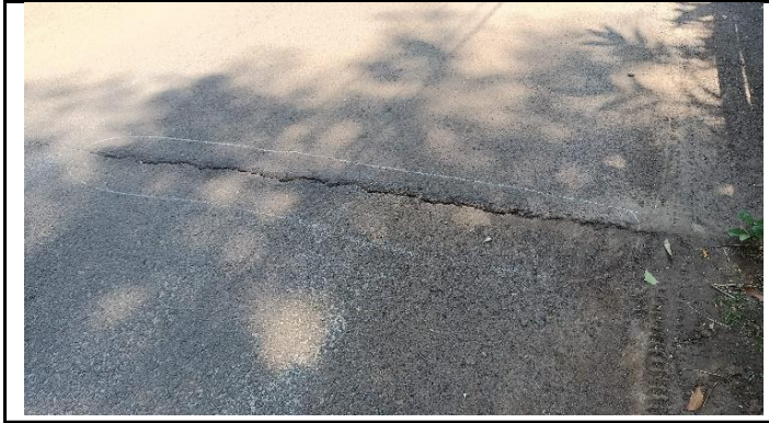
SAMBUNGAN LANTAI TIDAK SAMA TINGGI
