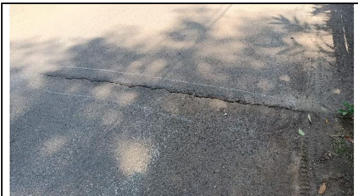
SAMBUNGAN LANTAI TIDAK SAMA TINGGI
