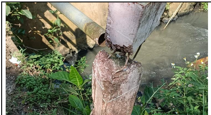
KERUSAKAN PADA SANDARAN
