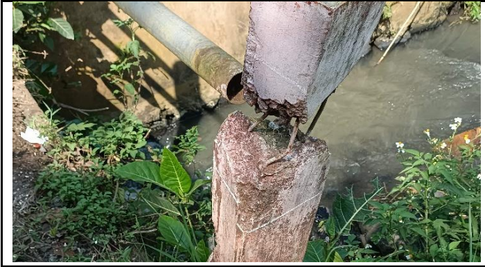
KERUSAKAN PADA SANDARAN
