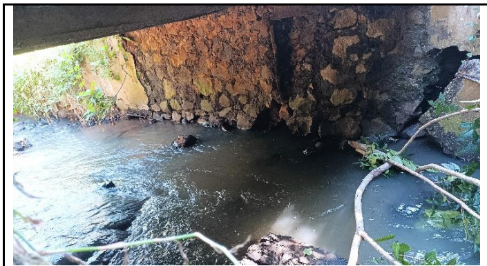
KEPALA JEMBATAN RETAK
