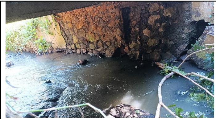
KEPALA JEMBATAN RETAK
