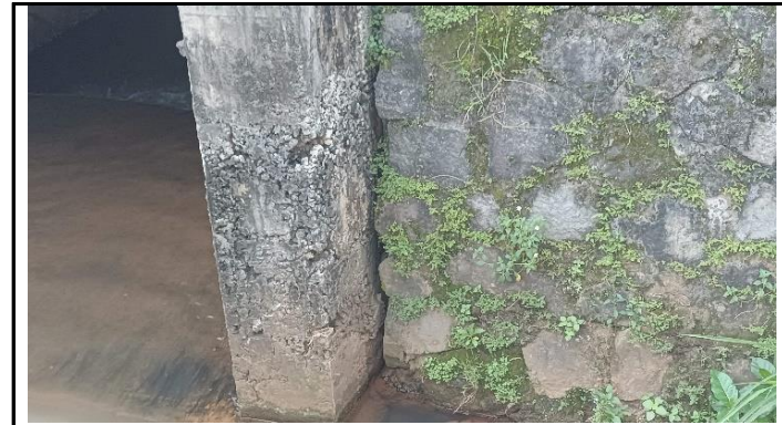
TEMBOK SAYAP RETAK
