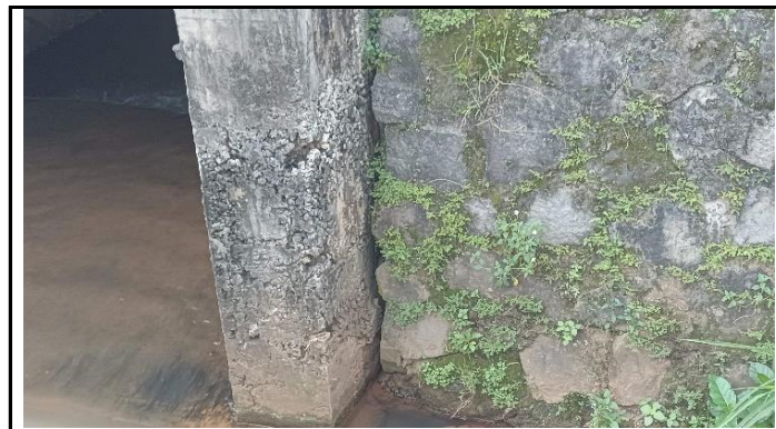
TEMBOK SAYAP RETAK
