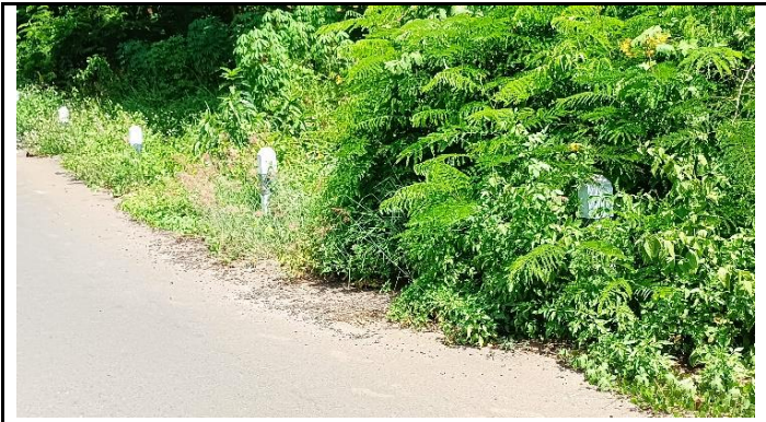
KONDISI PENGAMAN JALAN PENDEKAT
