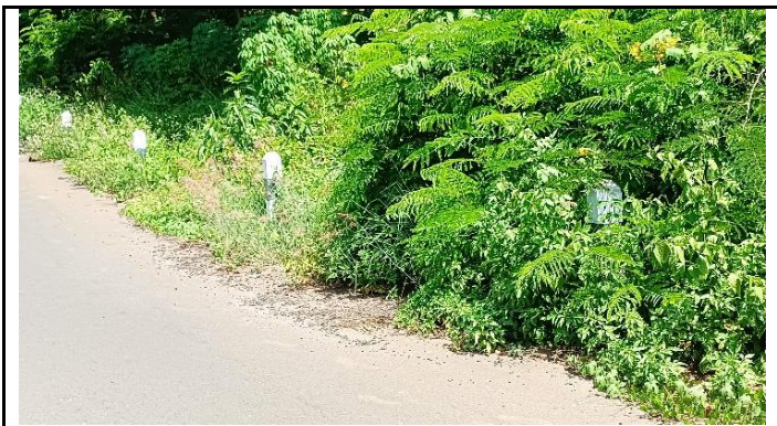
KONDISI PENGAMAN JALAN PENDEKAT
