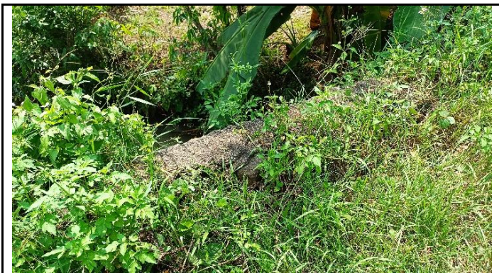
KONDISI PARAPET TERLALU RENDAH
