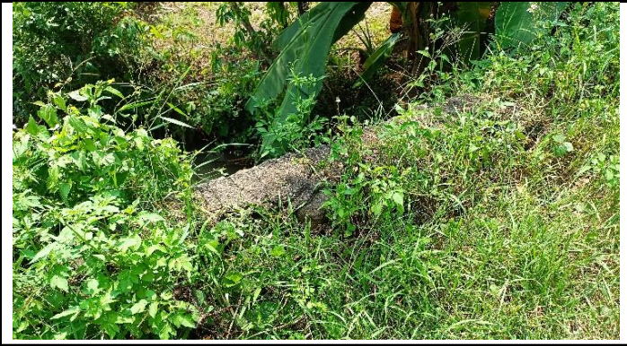
KONDISI PARAPET TERLALU RENDAH
