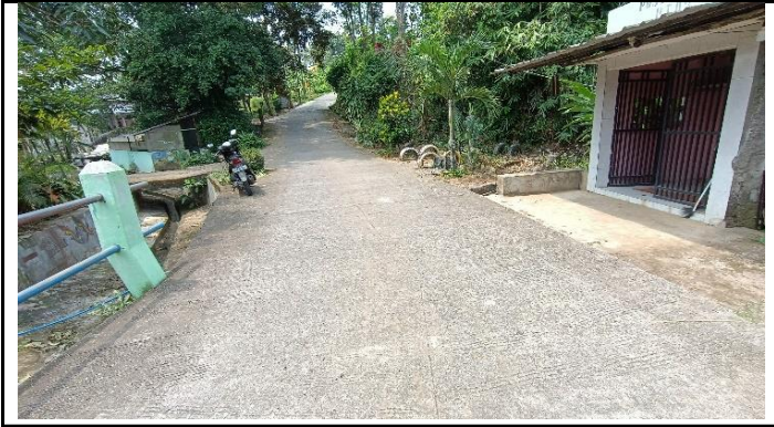
KONDISI LAPISAN PERMUKAAN LANTAI
