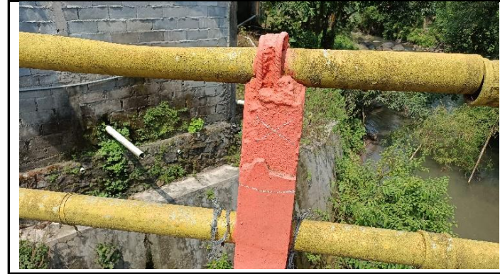
KERUSAKAN PADA SANDARAN JEMBATAN
