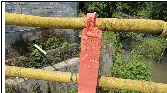
KERUSAKAN PADA SANDARAN JEMBATAN
