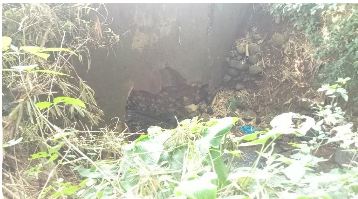
KEPALA JEMBATAN TERKIKIS
