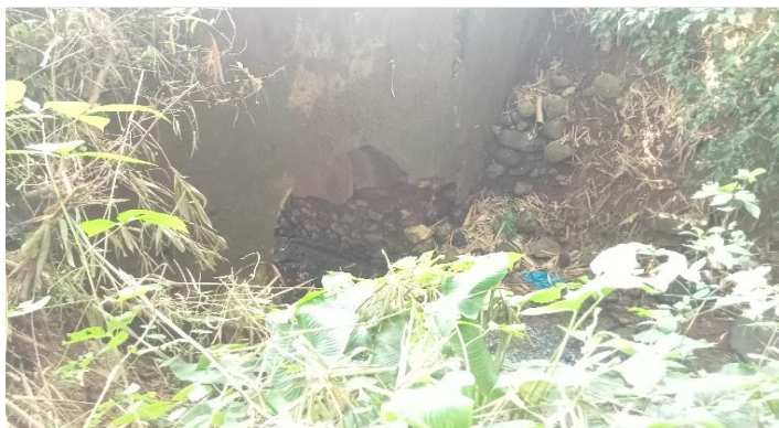
KEPALA JEMBATAN TERKIKIS
