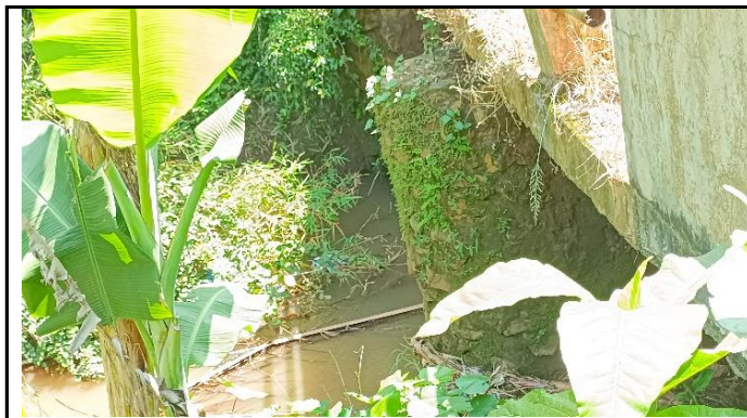
KONDISI PILAR MENGALAMI PENUAAN DAN BERLUMUT
