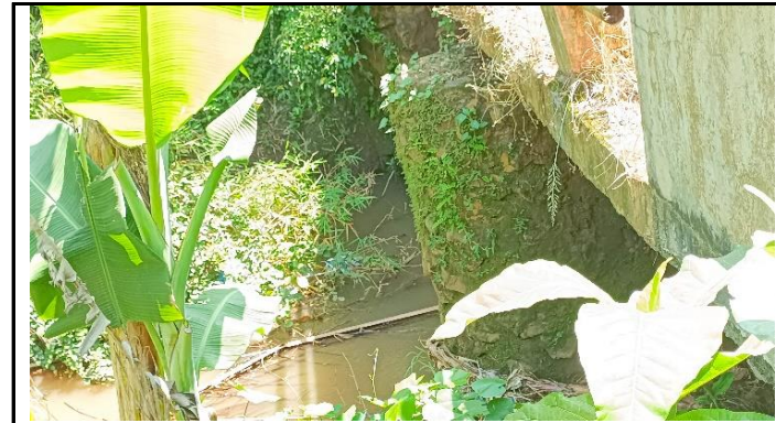
KONDISI PILAR MENGALAMI PENUAAN DAN BERLUMUT
