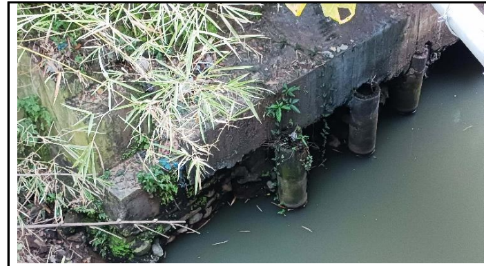
KONDISI PONDASI JEMBATAN TERGERUS
