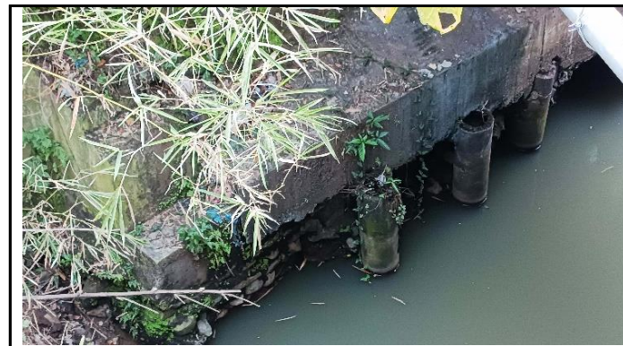
KONDISI PONDASI JEMBATAN TERGERUS
