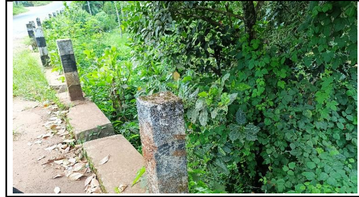
KONDISI TIANG PENGAMAN JALAN PENDEKAT
