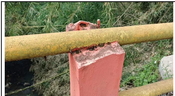
KERUSAKAN PADA SANDARAN
