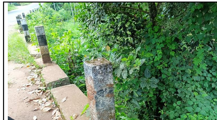
KONDISI TIANG PENGAMAN JALAN PENDEKAT
