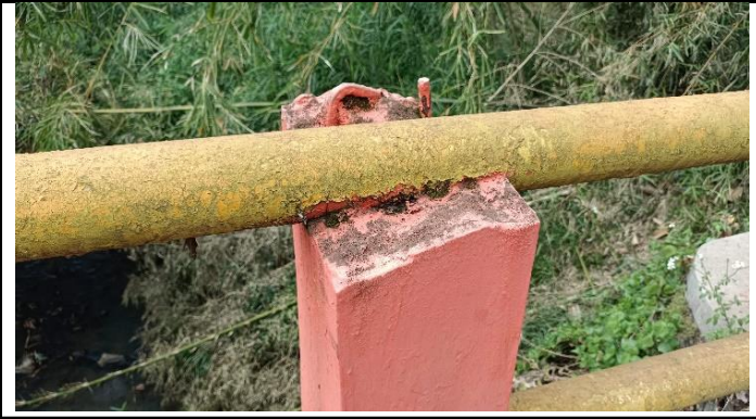
KERUSAKAN PADA SANDARAN
