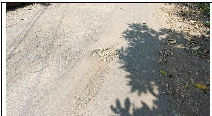
LAPISAN PERMUKAAN LANTAI BERLUBANG
