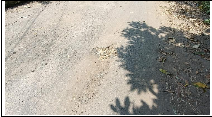
LAPISAN PERMUKAAN LANTAI BERLUBANG
