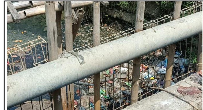
PIPA UTILITAS KOTOR DAN BERKARAT
