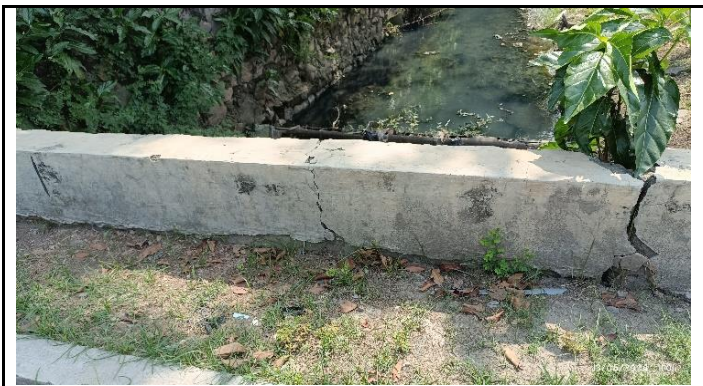
KERETAKAN PADA SANDARAN
