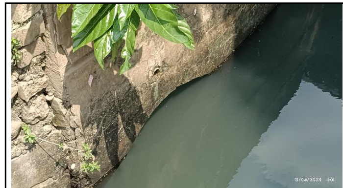
KONDISI BANGUNAN BAWAH TERTUTUP SEDIMENTASI
