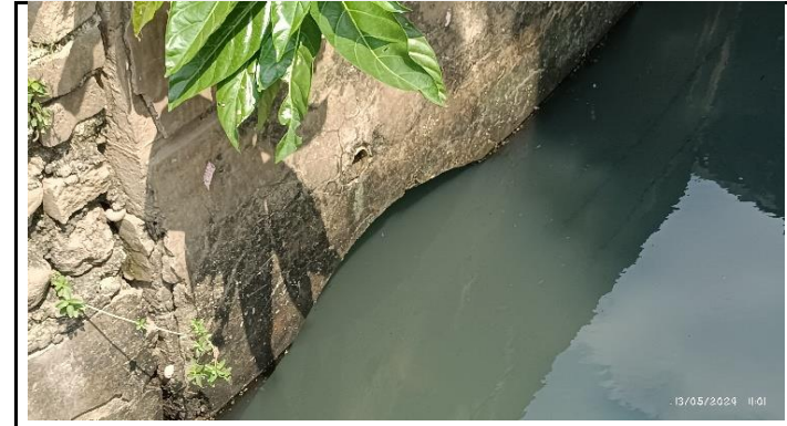
KONDISI BANGUNAN BAWAH TERTUTUP SEDIMENTASI
