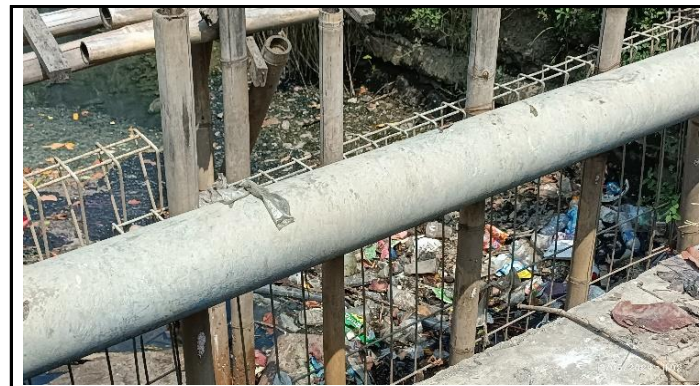
PIPA UTILITAS KOTOR DAN BERKARAT
