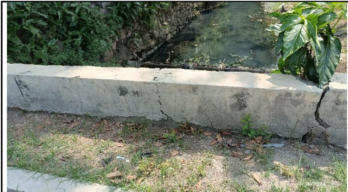
KERETAKAN PADA SANDARAN
