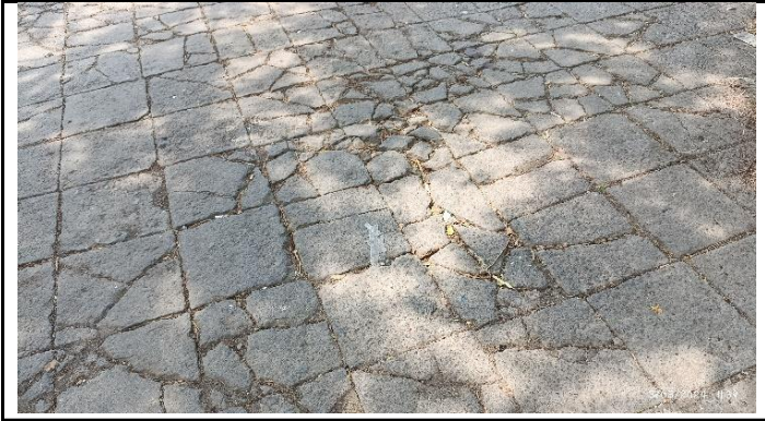
KONDISI LANTAI RETAK
