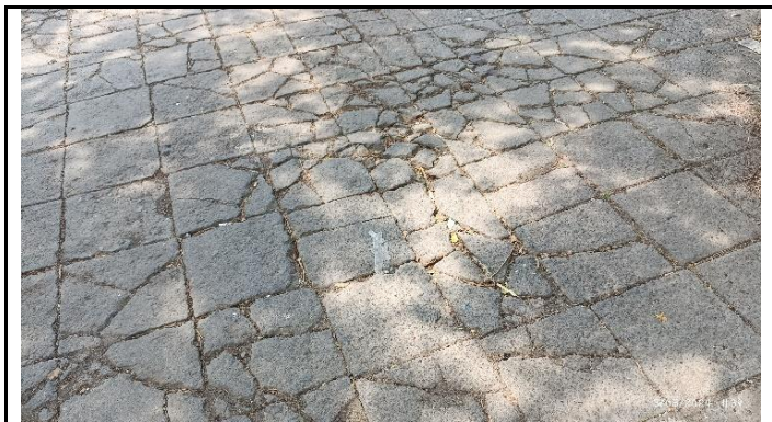
KONDISI LANTAI RETAK
