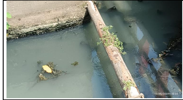
PIPA UTILITAS BERKARAT
