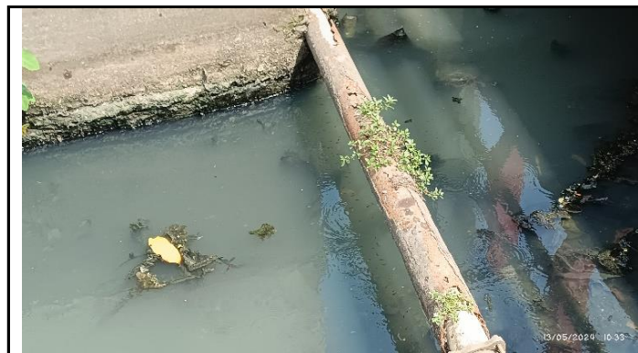
PIPA UTILITAS BERKARAT
