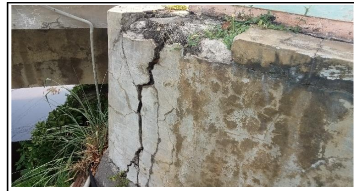
KERETAKAN PADA DINDING PENAHAN TANAH JALAN PENDEKAT
