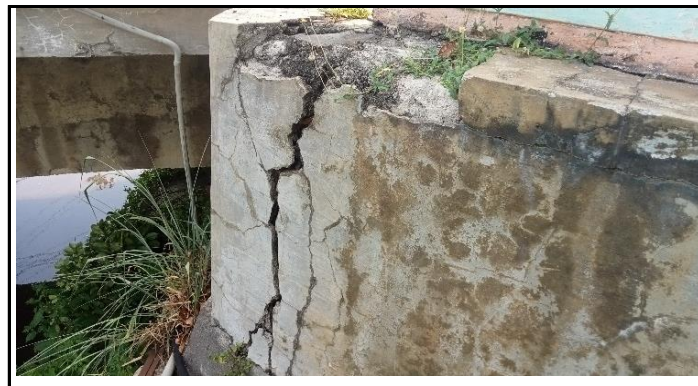
KERETAKAN PADA DINDING PENAHAN TANAH JALAN PENDEKAT
