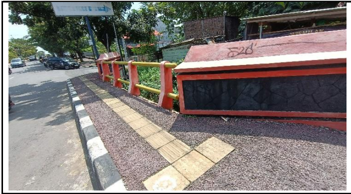
KONDISI TROTOAR DAN SANDARAN
