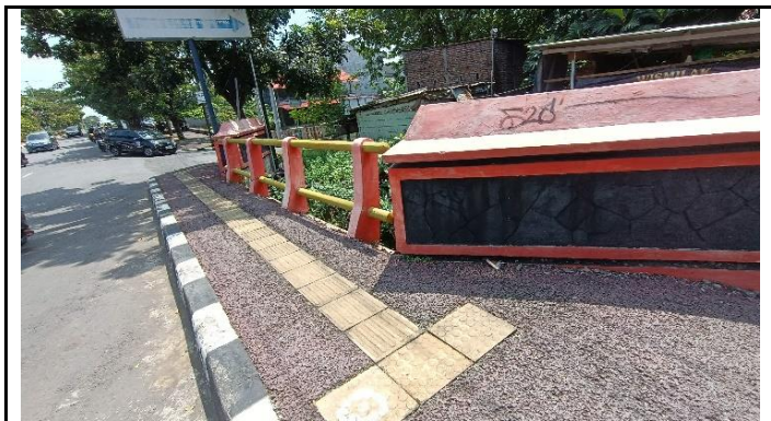
KONDISI TROTOAR DAN SANDARAN
