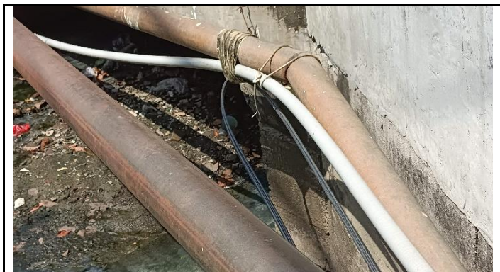
PIPA UTILITAS AIR MINUM BERKARAT
