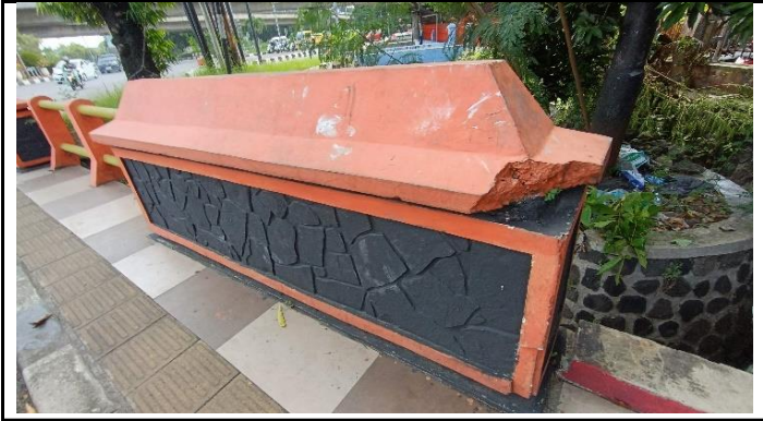
TEMBOK SEDADA RETAK
