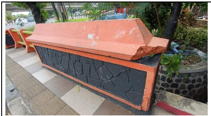
TEMBOK SEDADA RETAK
