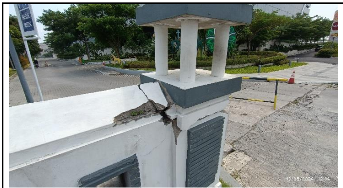
KERETAKAN PADA SANDARAN
