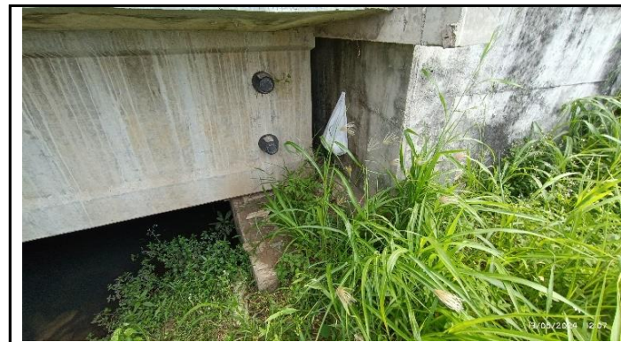
KONDISI GELAGAR PRATEKAN
