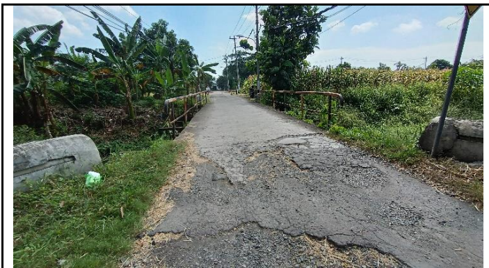
KERUSAKAN PADA JALAN PENDEKAT
