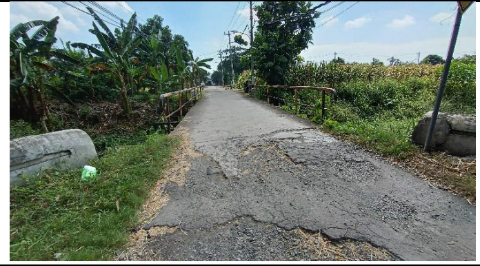
KERUSAKAN PADA JALAN PENDEKAT
