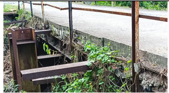
PILAR JEMBATAN BAILEY BERKARAT
