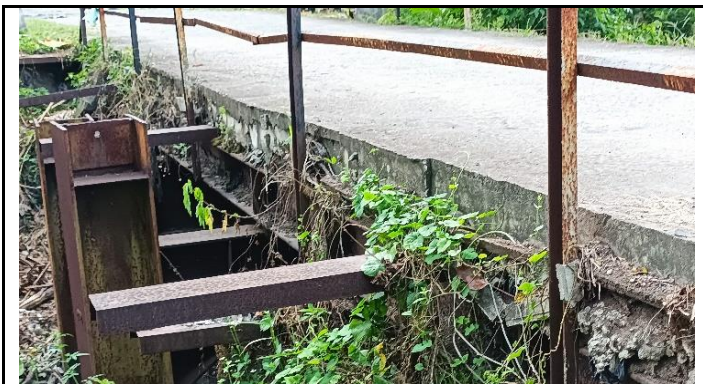
PILAR JEMBATAN BAILEY BERKARAT
