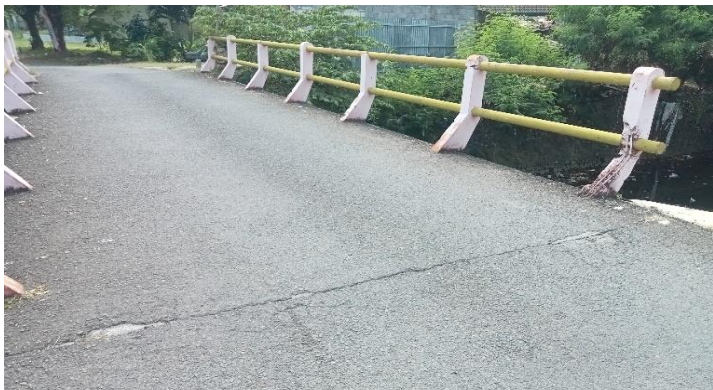
KONDISI LAPISAN PERMUKAAN LANTAI
