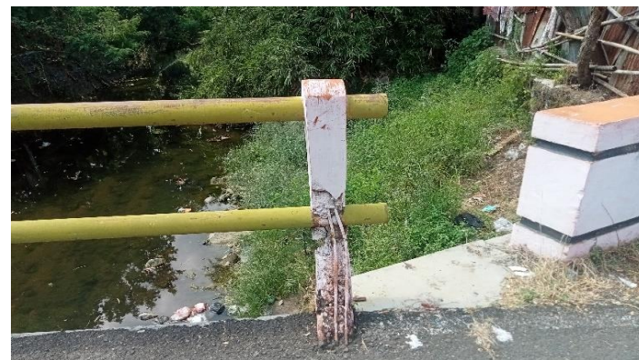
TIANG SANDARAN PECAH
