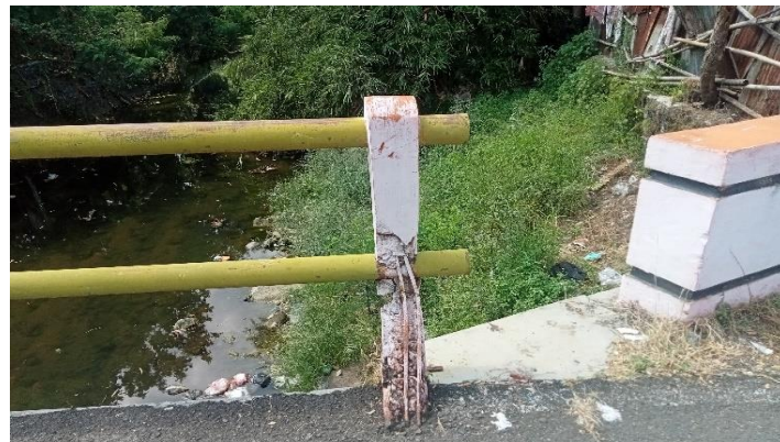
TIANG SANDARAN PECAH
