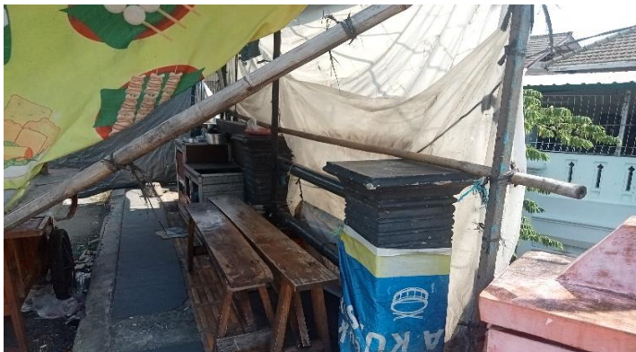
KONDISI SANDARAN DAN TROTOAR BANYAK TUMPUKAN BARANG PKL
