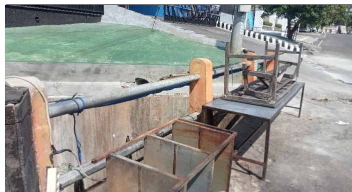
KONDISI SANDARAN RAILING
