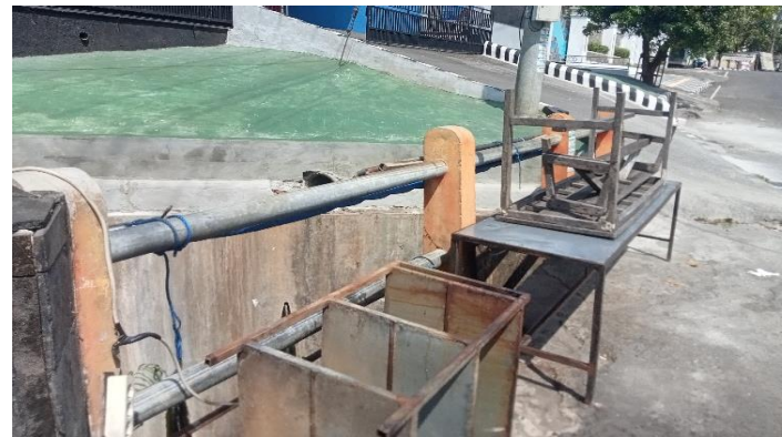
KONDISI SANDARAN RAILING
