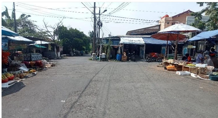
KONDISI LAPISAN PERMUKAAN LANTAI
