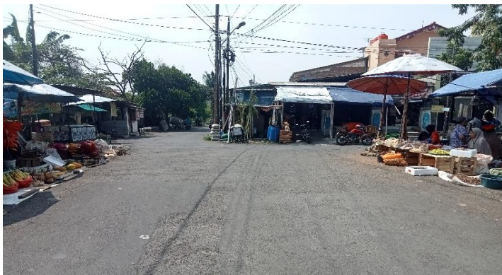
KONDISI LAPISAN PERMUKAAN LANTAI
