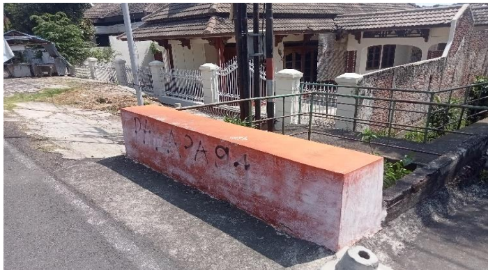
KONDISI SANDARAN / PARAPET TEMBOK SEDADA
