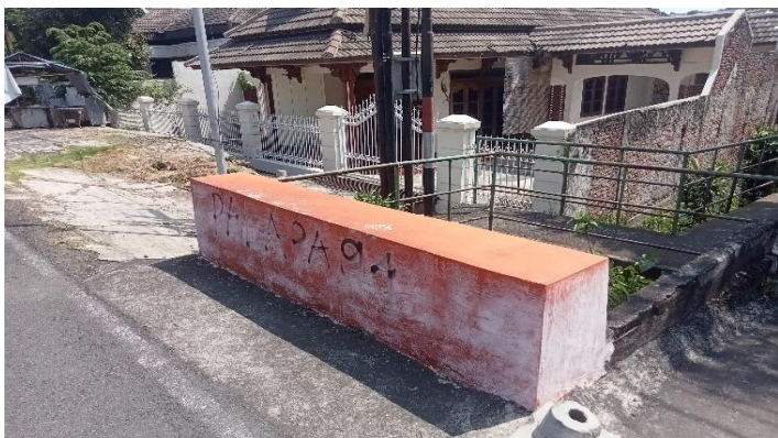
KONDISI SANDARAN / PARAPET TEMBOK SEDADA
