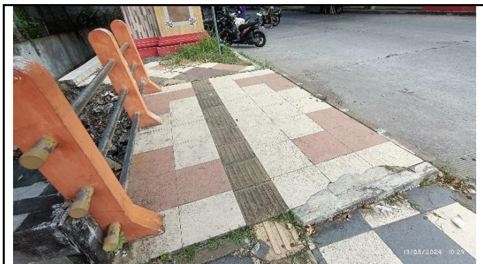
KONDISI TROTOAR DAN SANDARAN
