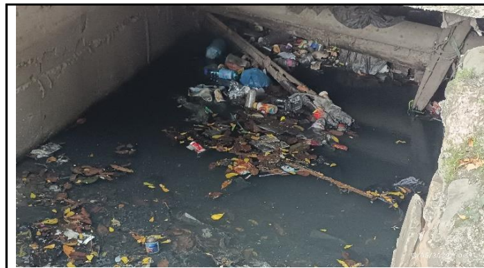
KONDISI ALIRAN AIR TERJADI PENUMPUKAN SAMPAH
