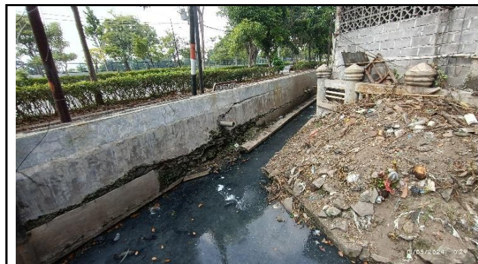
BANGUNAN PENGAMAN TEBING SUNGAI RETAK
