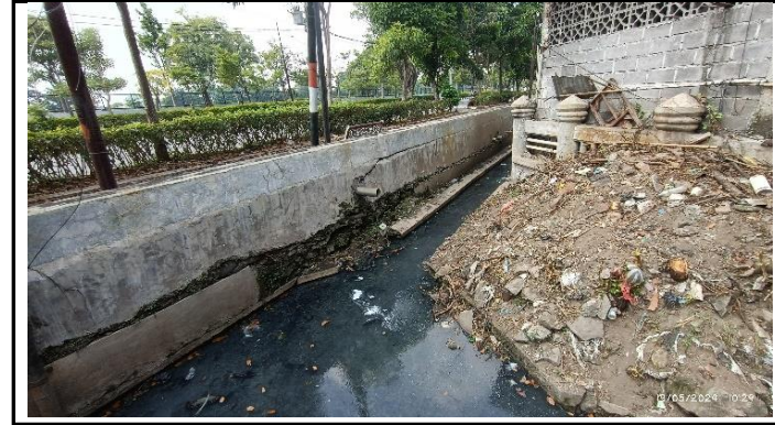
BANGUNAN PENGAMAN TEBING SUNGAI RETAK
