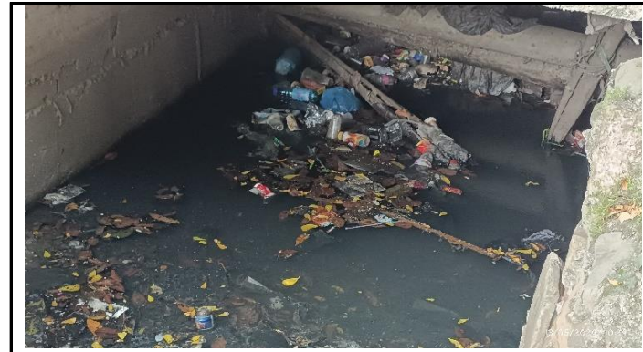
KONDISI ALIRAN AIR TERJADI PENUMPUKAN SAMPAH
