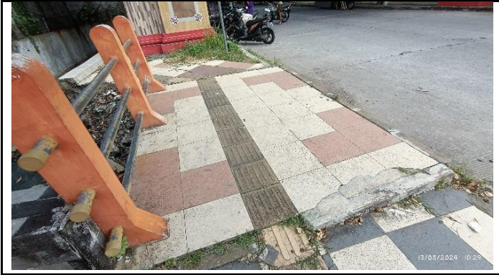
KONDISI TROTOAR DAN SANDARAN
