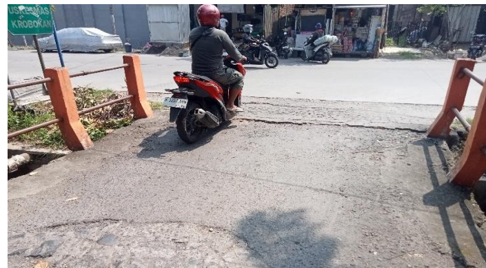
KONDISI LAPISAN PERMUKAAN LANTAI
