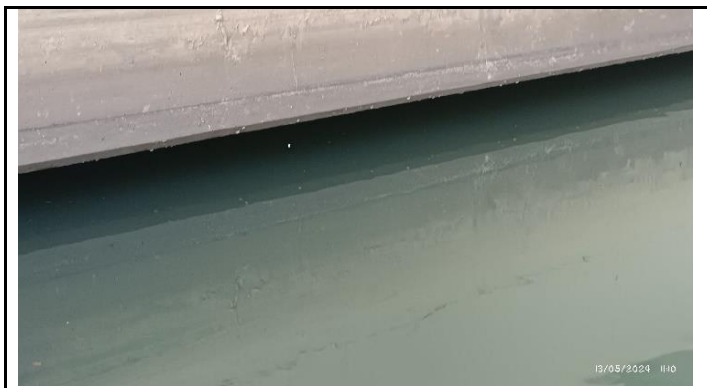
BANGUNAN BAWAH TERTUTUP SEDIMENTASI
