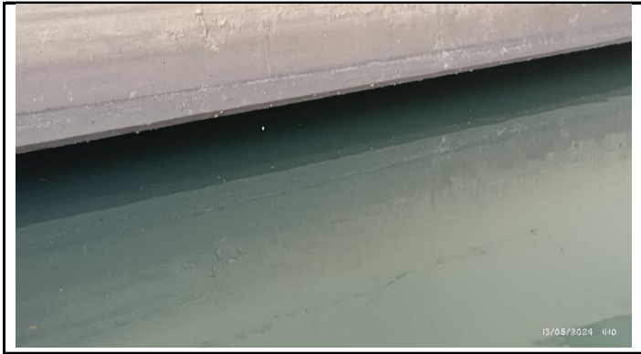
BANGUNAN BAWAH TERTUTUP SEDIMENTASI
