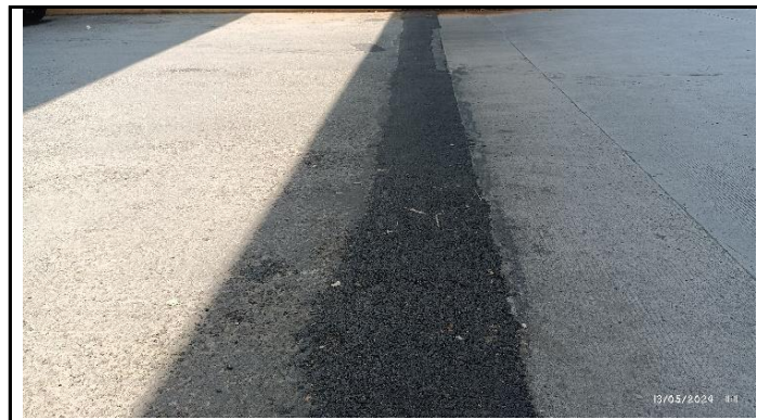
PENAMBALAN PADA SAMBUNGAN LANTAI JEMBATAN
