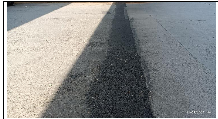
PENAMBALAN PADA SAMBUNGAN LANTAI JEMBATAN
