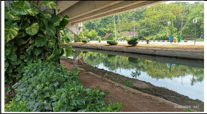
KONDISI ALIRAN SUNGAI PENUH SEDIMENTASI
