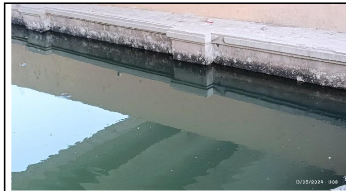
KONDISI BANGUNAN BAWAH TERTUTUP SEDIMENTASI
