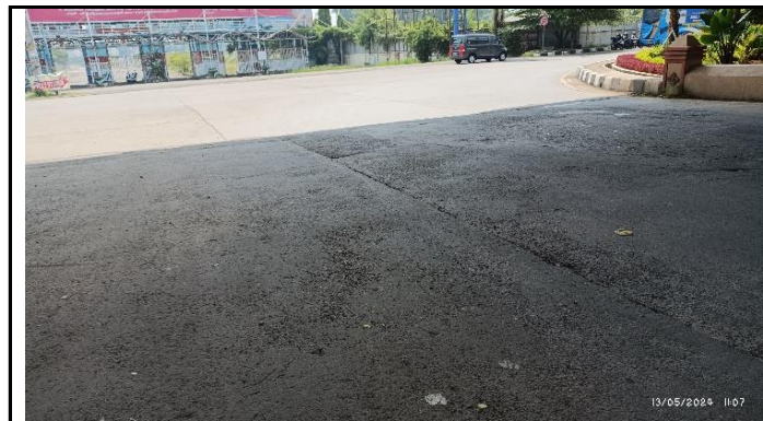
LAPISAN PERMUKAAN LANTAI BERGELOMBANG
