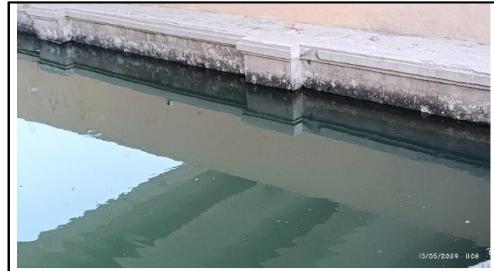
KONDISI BANGUNAN BAWAH TERTUTUP SEDIMENTASI
