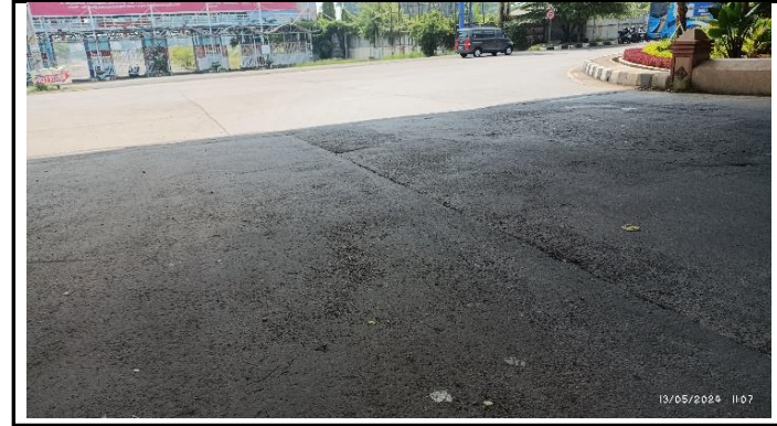
LAPISAN PERMUKAAN LANTAI BERGELOMBANG
