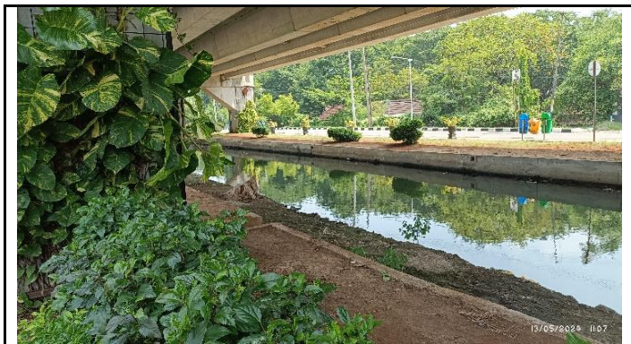
KONDISI ALIRAN SUNGAI PENUH SEDIMENTASI
