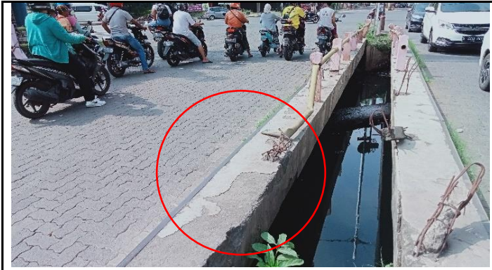
KERUSAKAN PADA SANDARAN
