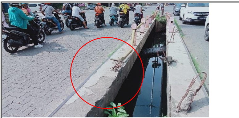
KERUSAKAN PADA SANDARAN
