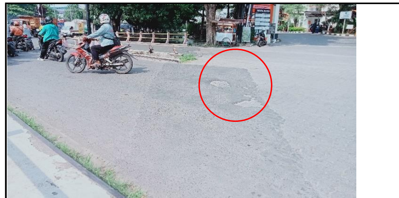
KERUSAKAN PADA LAPISAN LANTAI
