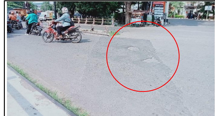
KERUSAKAN PADA LAPISAN LANTAI
