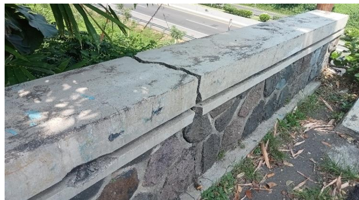
PARAPET / TEMBOK SEDADA PECAH
