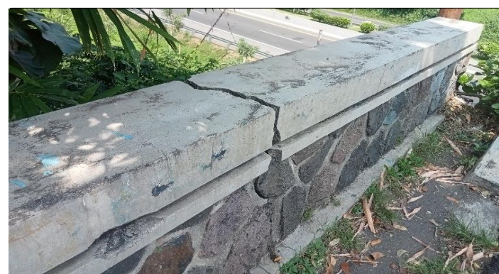
PARAPET / TEMBOK SEDADA PECAH
