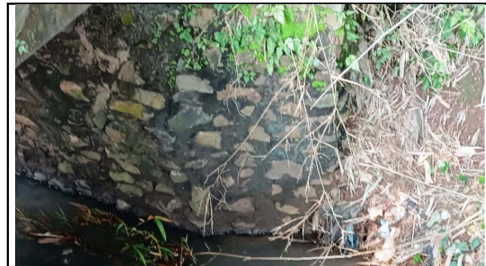
DINDING PENAHAN TANAH JALAN PENDEKAT RETAK
