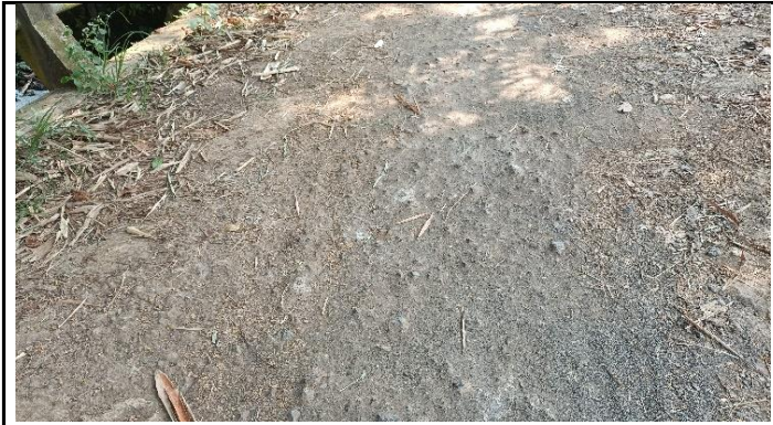
LAPISAN PERMUKAAN LANTAI BERGELOMBANG
