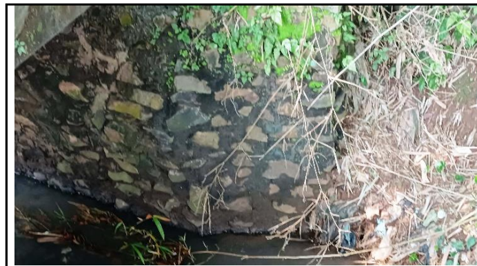
DINDING PENAHAN TANAH JALAN PENDEKAT RETAK
