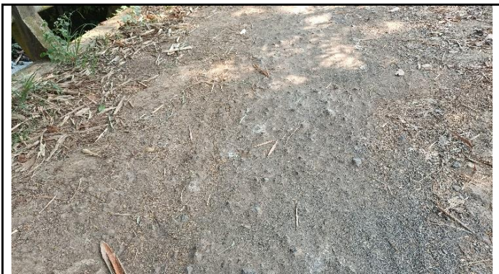
LAPISAN PERMUKAAN LANTAI BERGELOMBANG
