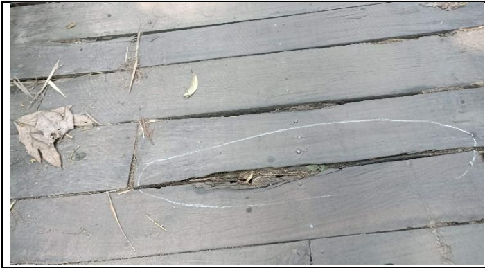
LANTAI KAYU JEMBATAN BERLUBANG
