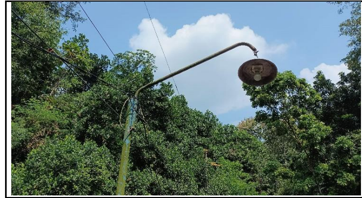
LAMPU PENERANGAN JEMBATAN
