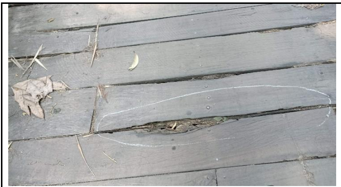
LANTAI KAYU JEMBATAN BERLUBANG
