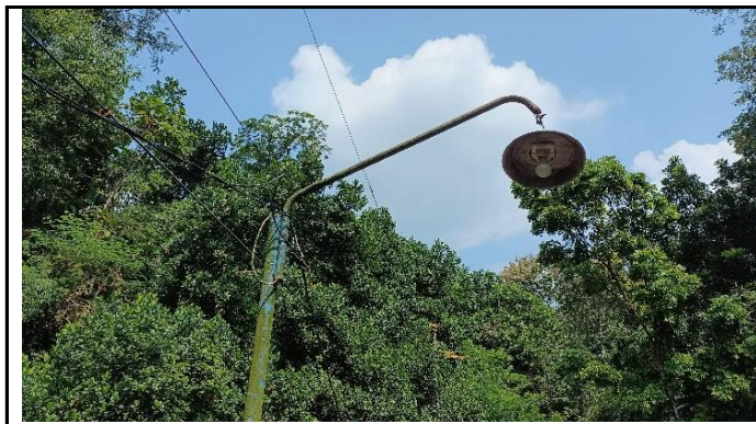
LAMPU PENERANGAN JEMBATAN
