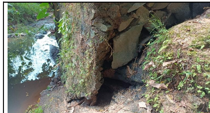
DINDING PENAHAN TANAH JALAN PENDEKAT MENGALAMI KERUSAKAN
