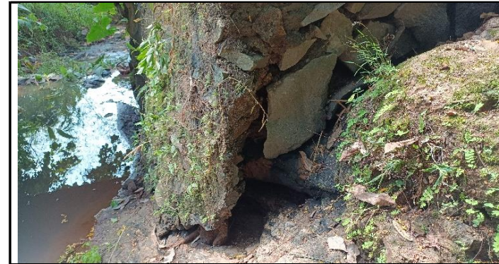
DINDING PENAHAN TANAH JALAN PENDEKAT MENGALAMI KERUSAKAN
