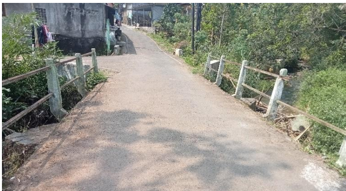
KONDISI LAPISAN PERMUKAAN LANTAI
