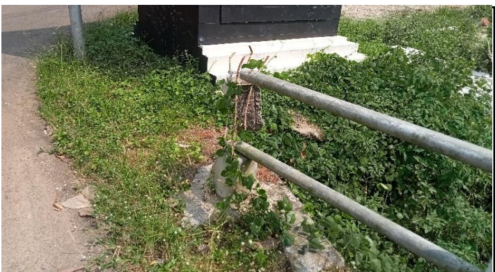
KONDISI TIANG SANDARAN PECAH
