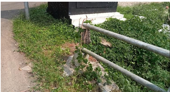
KONDISI TIANG SANDARAN PECAH
