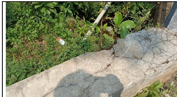
PARAPET JEMBATAN RETAK
