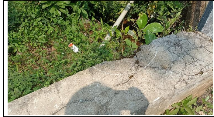
PARAPET JEMBATAN RETAK
