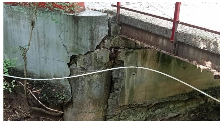
KEPALA JEMBATAN PECAH
