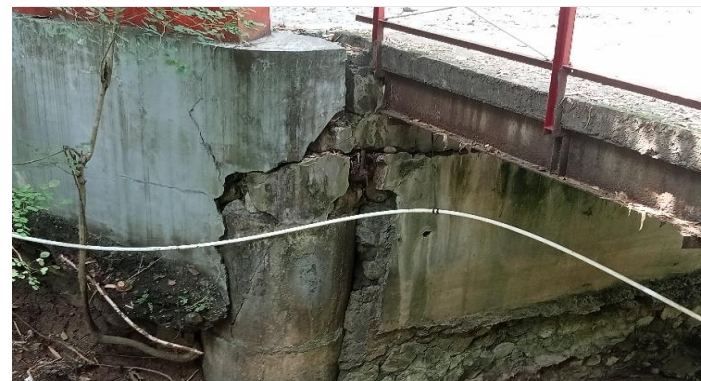
KEPALA JEMBATAN PECAH
